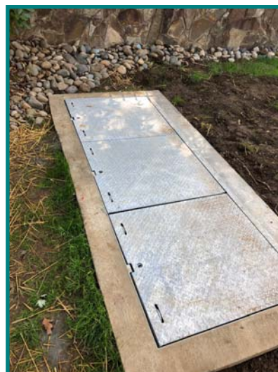
New Meter Vault Lid
